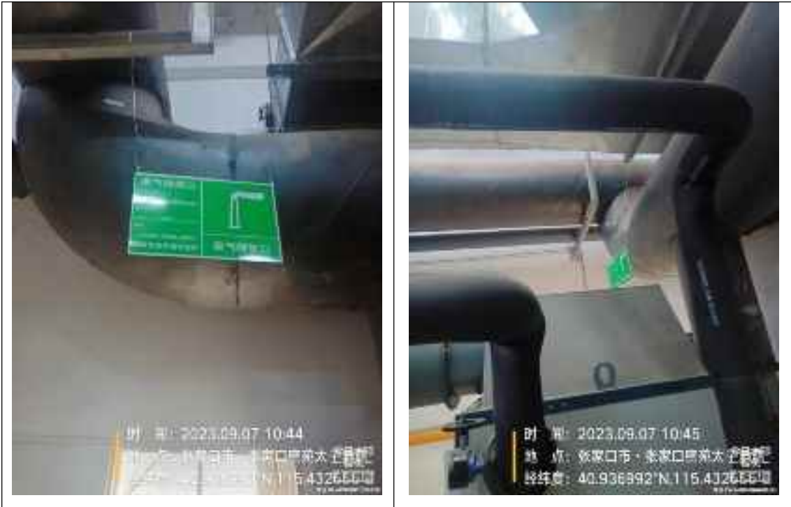
太子酒店锅炉房（2t/h、3t/h）-15号废气排放口
